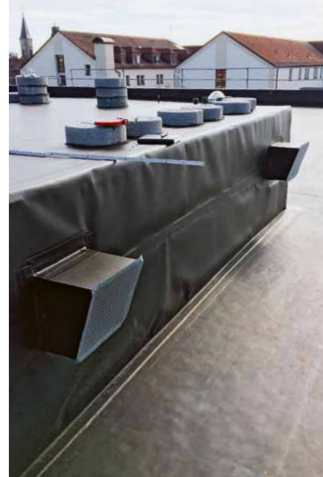
Aufzugsüberfahrt mit speziell angefertigten Lüftungsöffnungen
