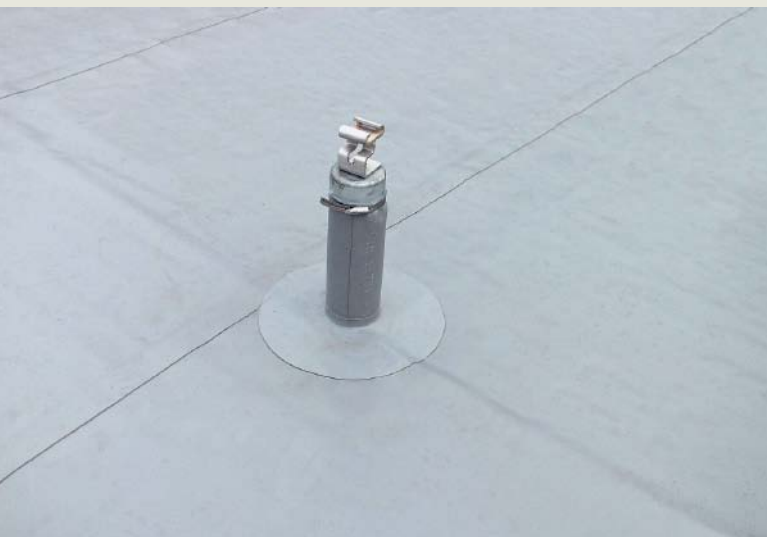
Fachgerecht eingefasst und sicher verschweißt: Sekuranten als „Ständige Sicherheitseinrichtung“ nach BGI 5164
