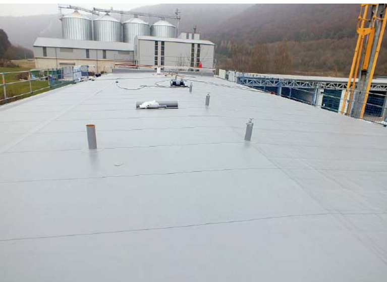
Flaches Satteldach der Betriebshalle Riedenburg: Die Abdichtung in Grau passt farblich zu den Titanzinkdächern im Hintergrund.
